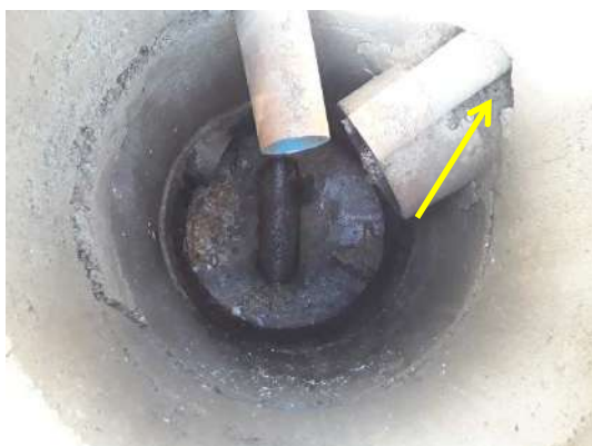
Branchement non étanche
