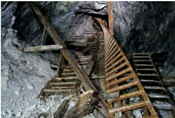
Base effondrée du grand escalier
